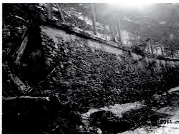
Danni al muro di contenimento - vista da valle
