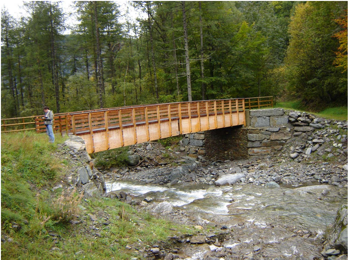
Foto 008 – Opera BATTPO010 . Ripresa da monte, sponda sinistra del T. Germanica di Massello.
