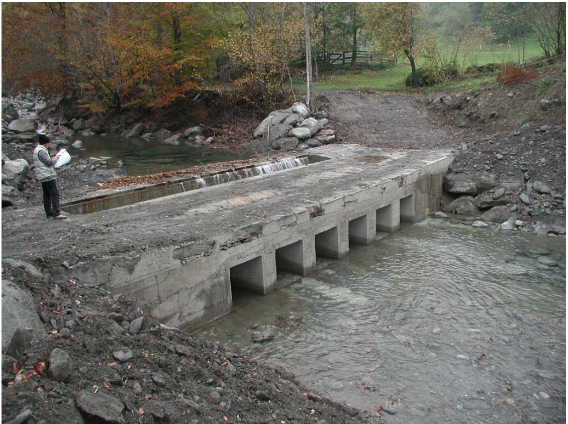
Foto 006 – Opera BATTAG008 . Ripresa da valle, sponda destra del T. Germanasca di Massello.
