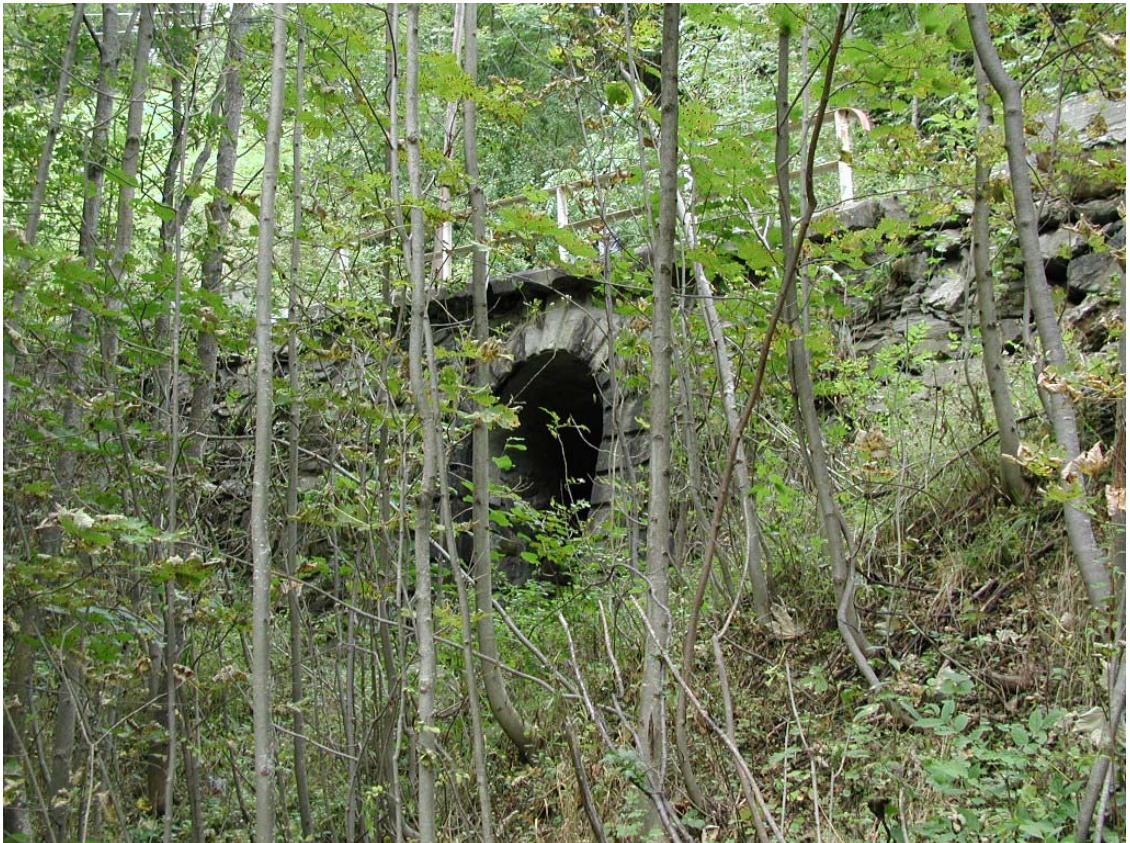
Foto 004 – Opera TREVAG006 . Foto scattata da valle verso monte, in sponda sinistra di un affluente del T. Germanasca di Massello.
