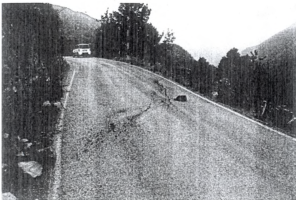
Foto 1 - Cedimento della sede stradale (Strada Provinciale n° 253) in corrispondenza del fianco orientale del dissesto.
