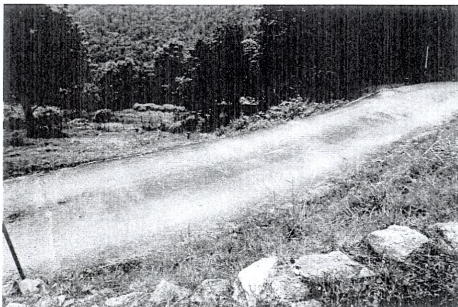
Immagine 04 - Cedimento della sede stradale, strada per località Saretto - Foto del 03/07/2008
