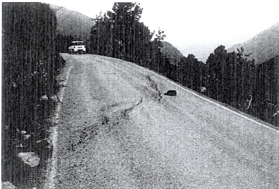
Immagine 01 - Cedimento della sede stradale (Strada Provinciale n°253) in corrispondenza del fianco orientale del dissesto - Foto del 03/07/2008
