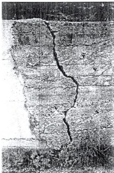
Foto 2 - Lesioni al muro in cemento armato posto immediatamente a monte della Strada Provinciale.
