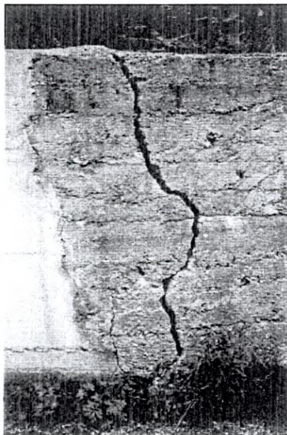
Immagine 02 - Lesioni al muro in cemento armato posto immediatamente a monte della Strada Provinciale - Foto del 03/07/2008
