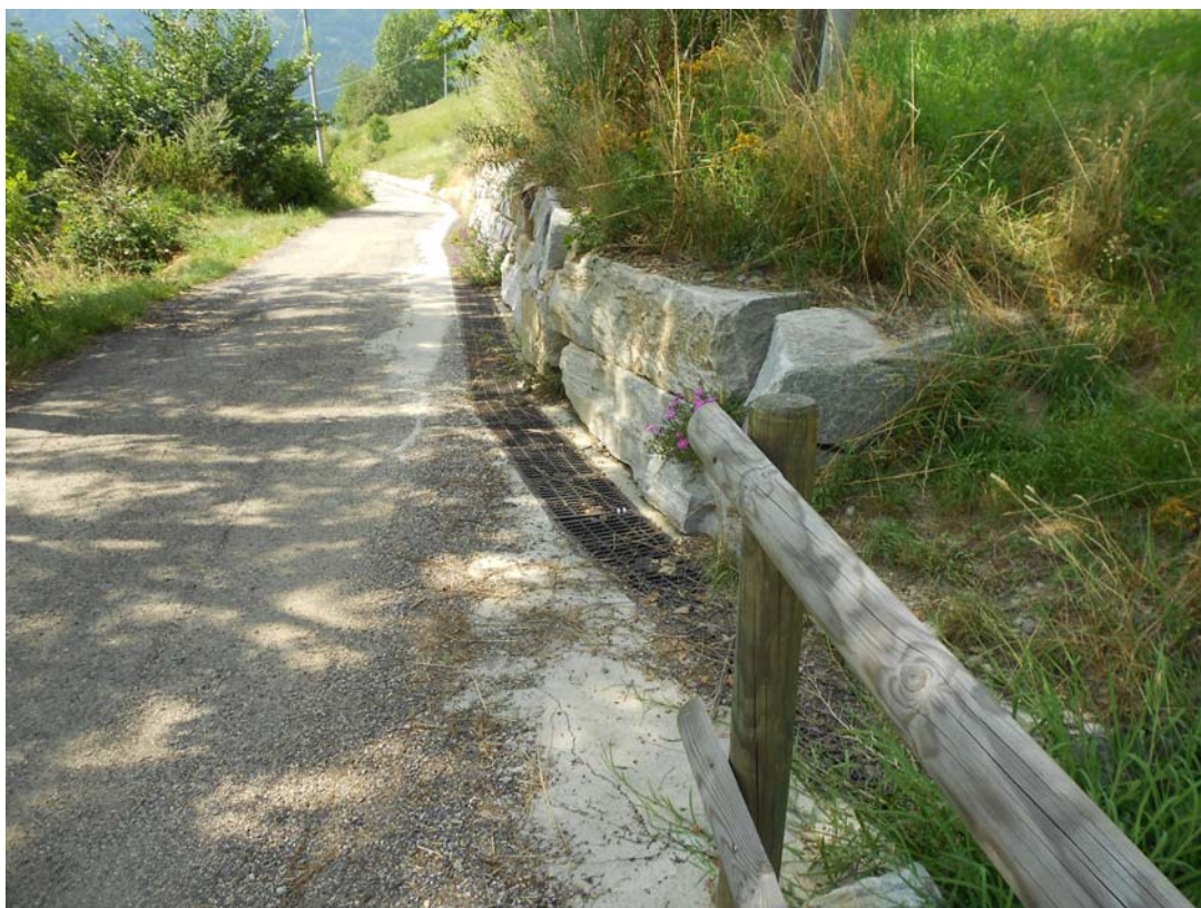
Foto 004 – Opera ZANECA003. Canaletta lungo la strada.
