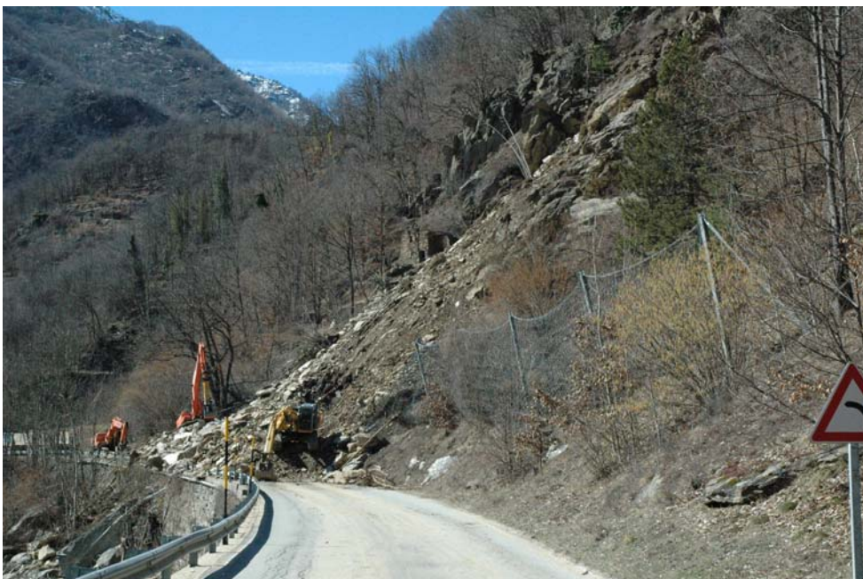
Immagine 02 - Vista del crollo da valle. Foto del 13.04.2011
