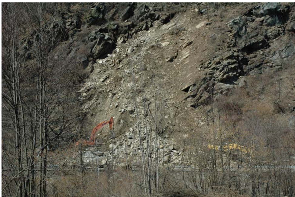
Immagine 04 - Vista frontale del crollo. Foto del 13.04.2011
