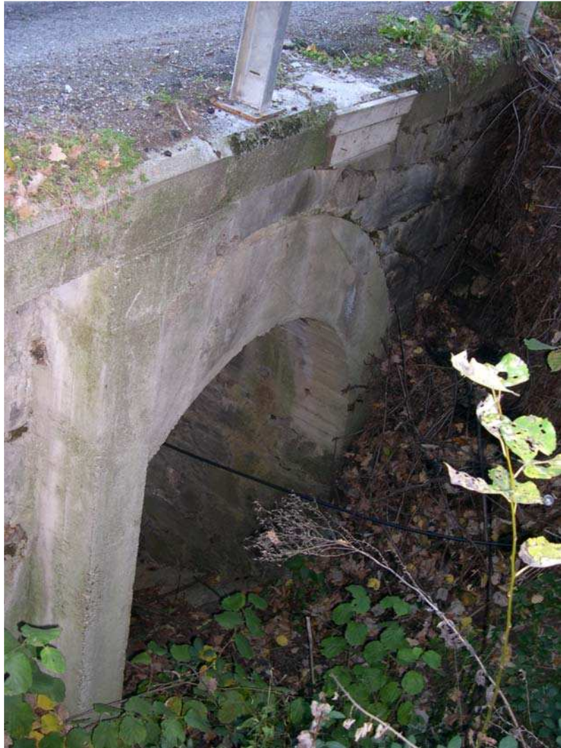
Foto 017 – Opera BATTAG018 . Ripresa da monte, sponda sinistra del rio affluente del T. Germanasca.
