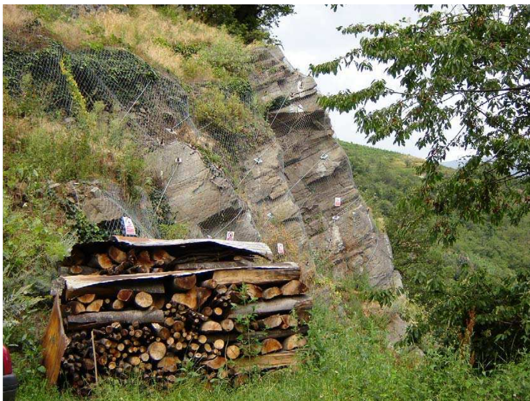
Foto 003 – Opera BATTPR003 (rete e cavi) . Ripresa dalla strada per Blegieri.
