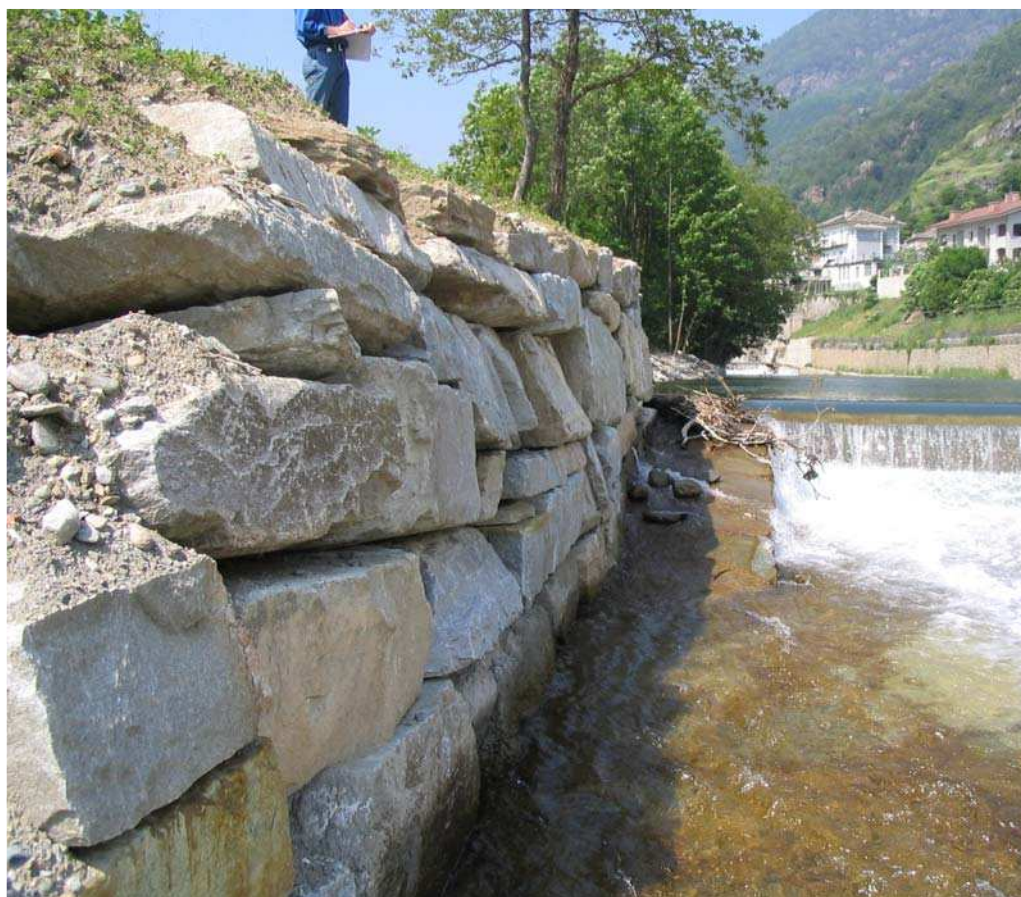
Foto 004 – Opera BATTDS004 . Ripresa da valle, interno alveo, sponda destra del T. Germanasca.
