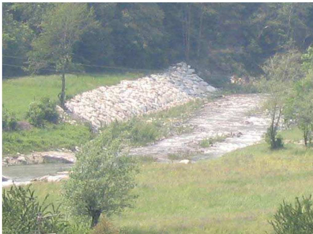
Foto 005 – Opera BATTDS005 . Ripresa da valle, sponda sinistra del T. Chisone, lungo la SR n. 23 del Colle del Sestriere.
